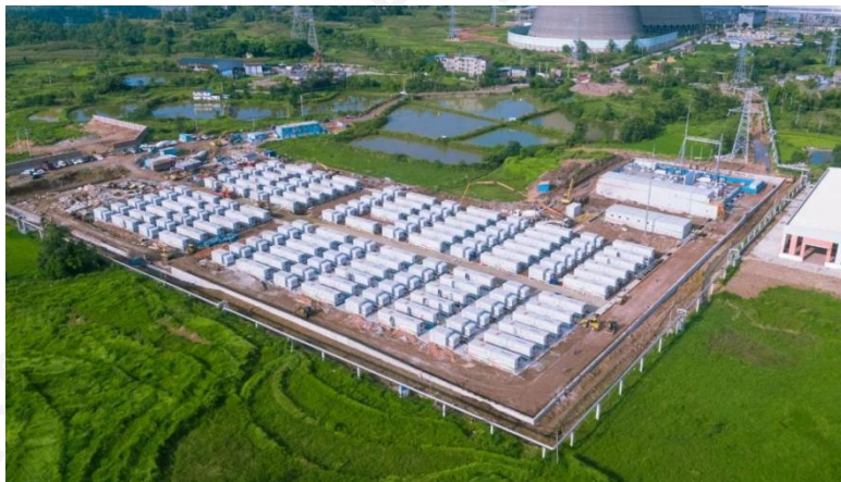
图 8.7 国家电投重庆公司 240MW/480MWh 电网侧共享储能电站
