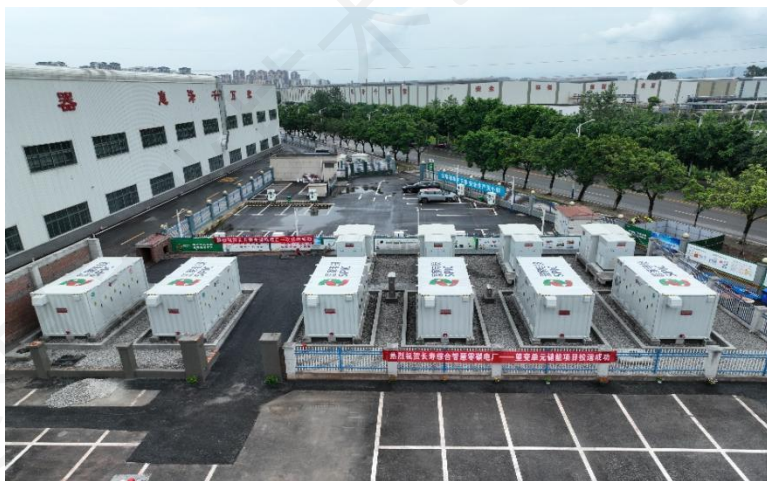
图 8.10 长寿望变综合智慧零碳园区用户侧储能电站图
