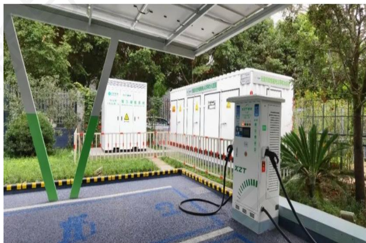
图 8.12 成都鑫众泰零碳示范园用户侧储能电站图
