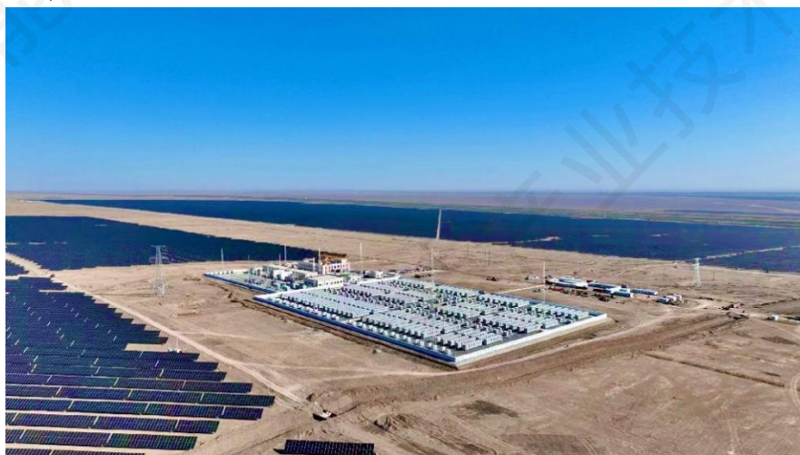
图 1.25 新华发电莎车光储一体化项目 (200MW/800MWh)
